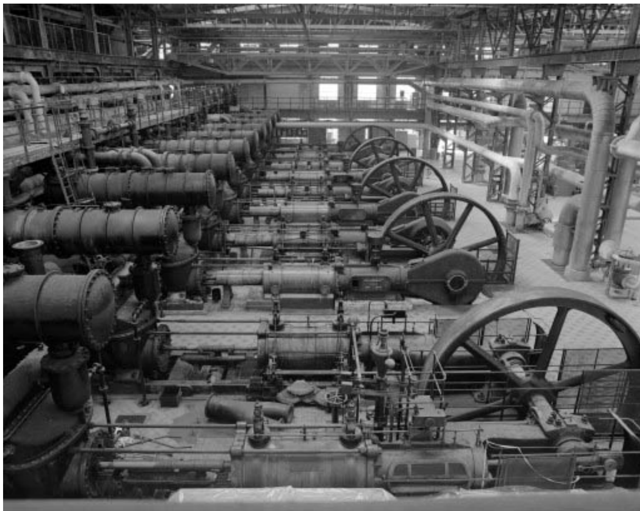
Soudière (10), salle des machines : vue d'ensemble des pompes à gaz.
