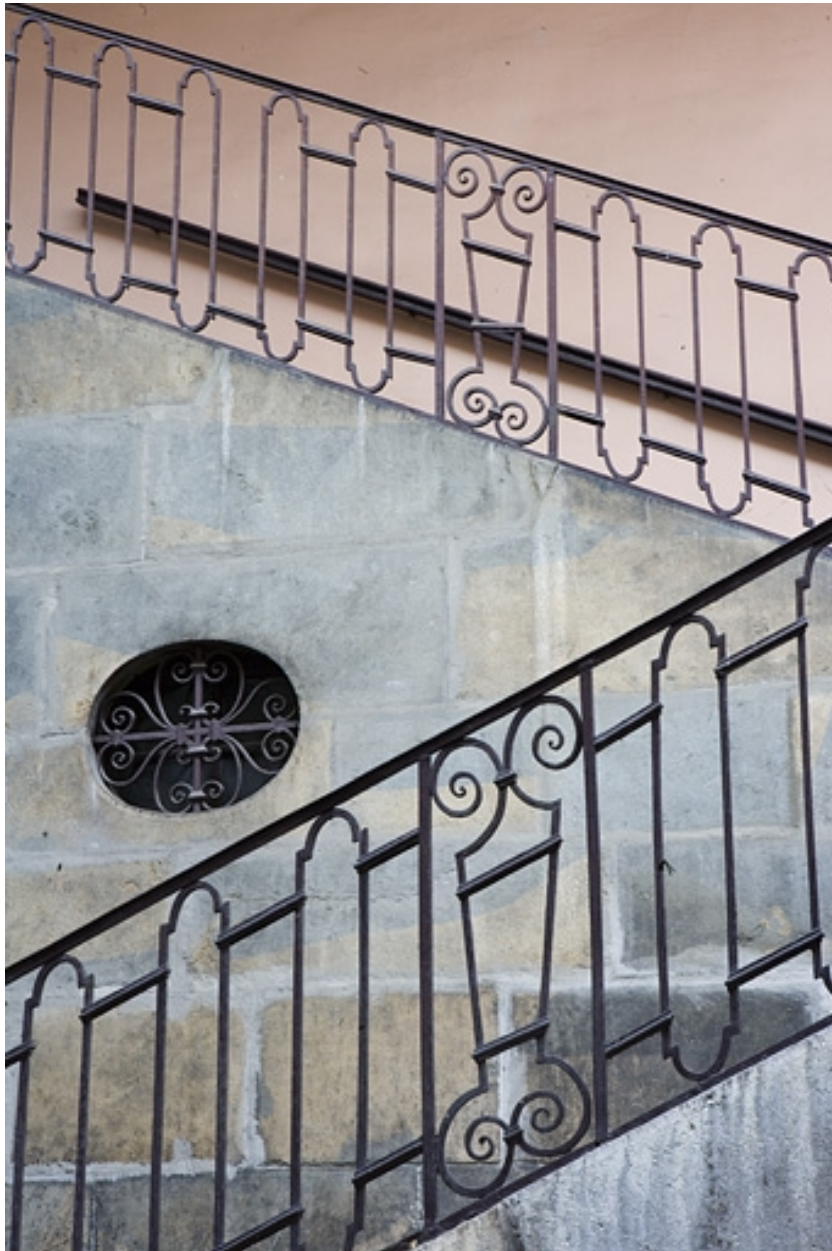
Détail de la rampe de l'escalier à cage ouverte à gauche de la deuxième cour.
