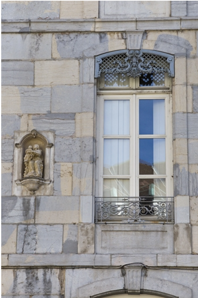
Logis principal, façade antérieure : détail d'une fenêtre et de la niche gauche.
