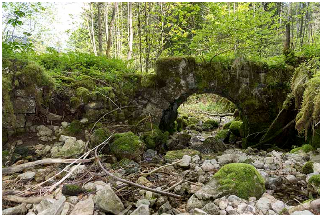
Pont en ruine.
