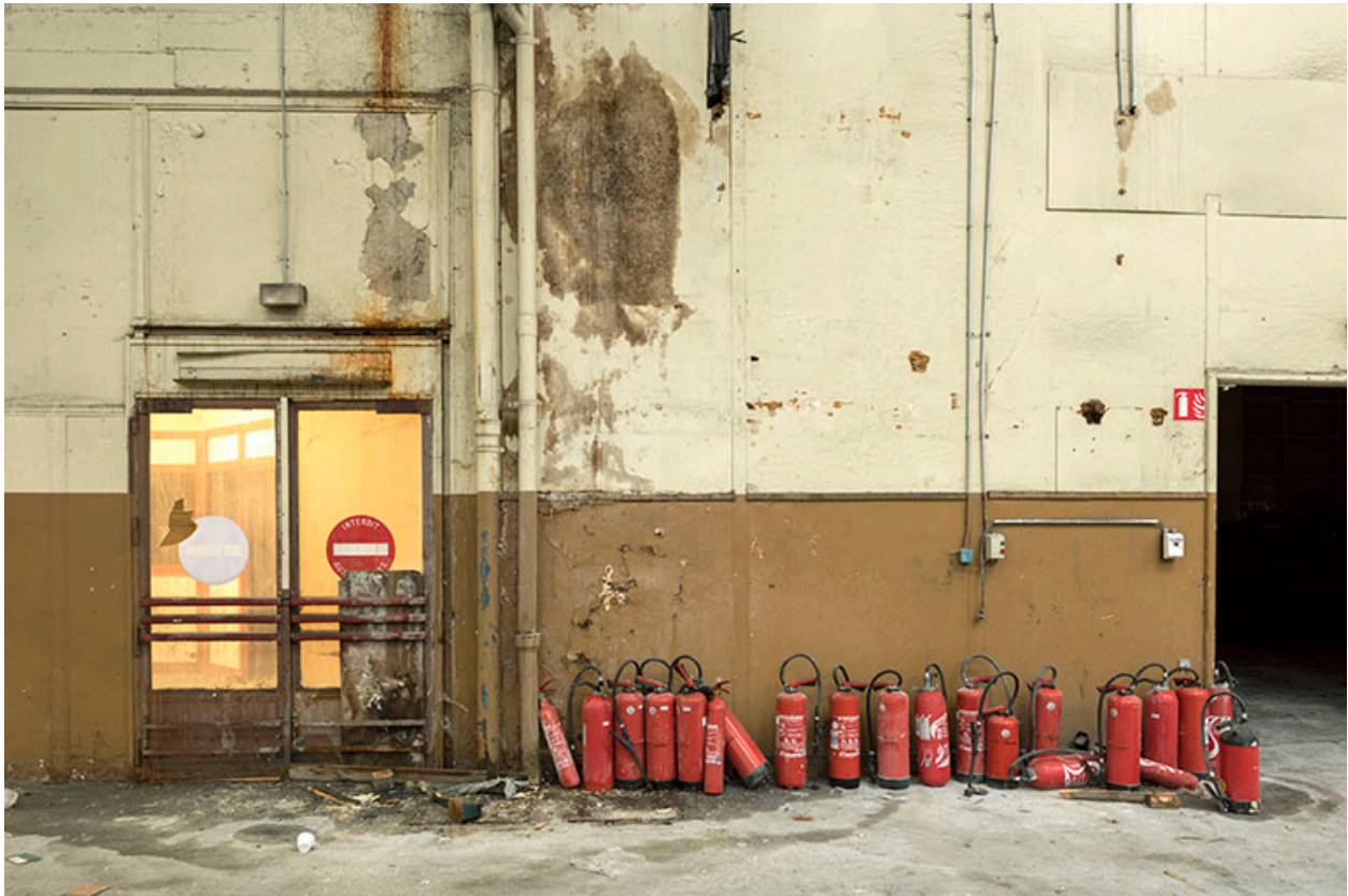
Etat en 2016. Usine A : extincteurs à l'intérieur de l'atelier de réparation.
