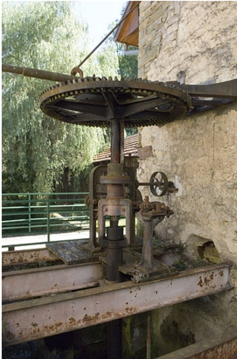
Turbine hydraulique. Partie supérieure de la transmission.
