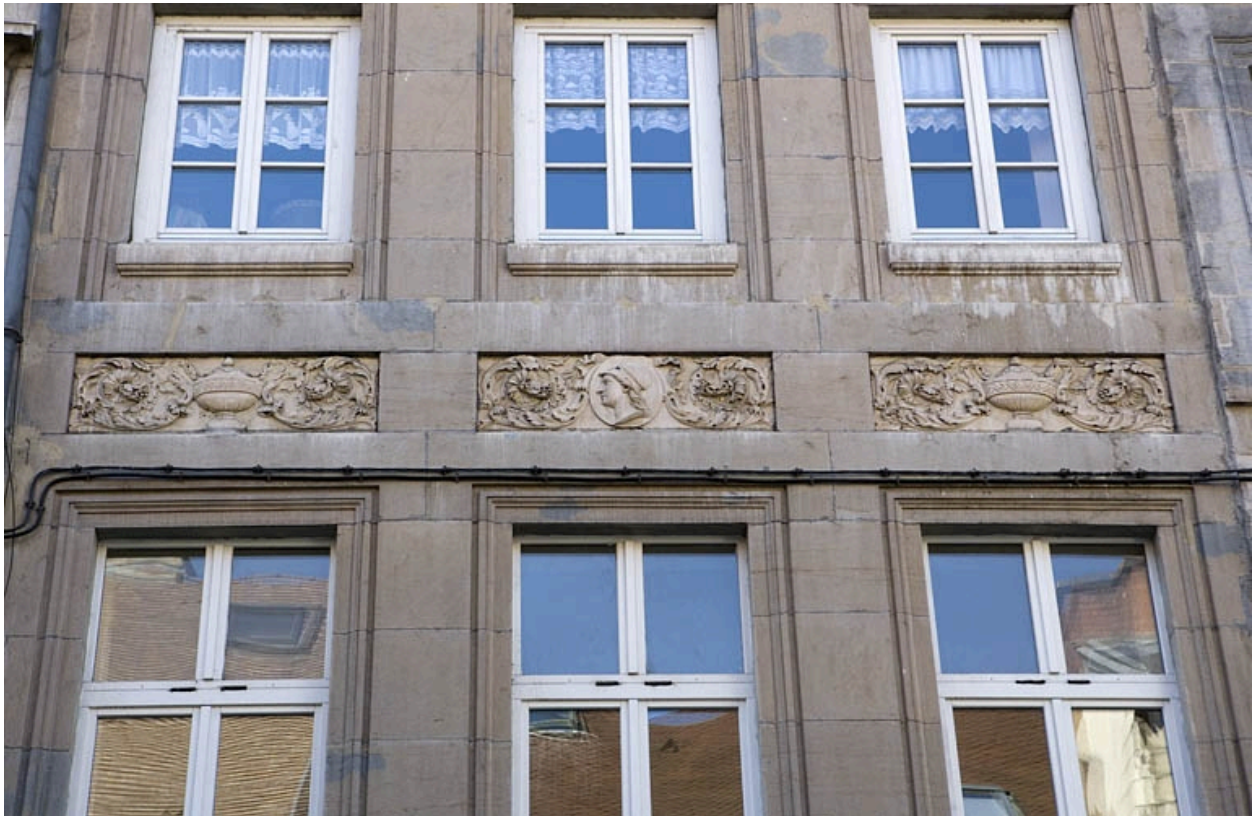
Détail du décor des tables rentrantes entre le premier et le deuxième étage.
