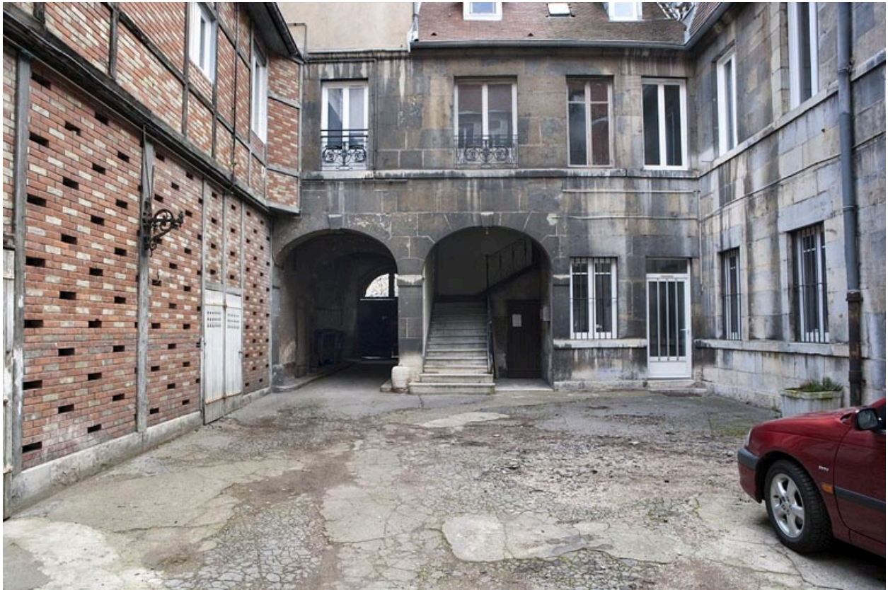
Vue d'ensemble des communs et du bûcher depuis l'entrée de la cour.
