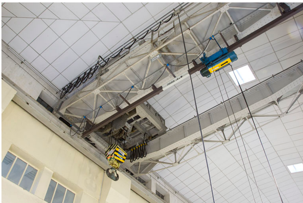
Centrale : face inférieure du pont roulant.
