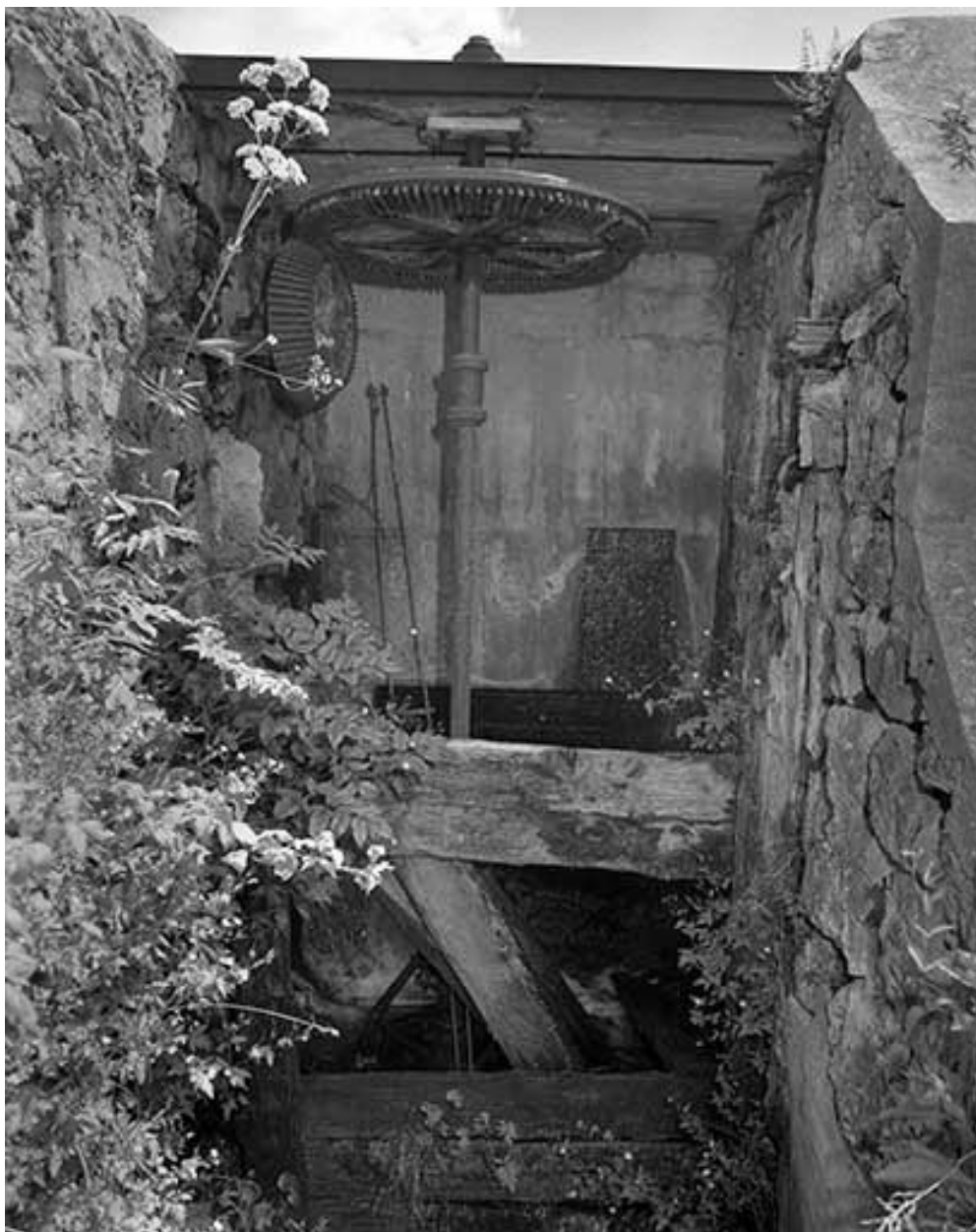
Système de roues hydrauliques, vue générale.
