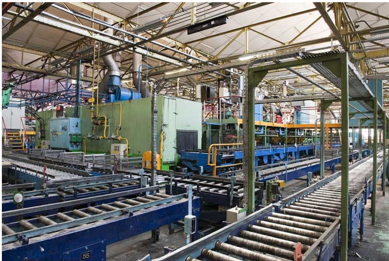
Atelier de rénovation des moteurs. Chaîne désaffectée.
