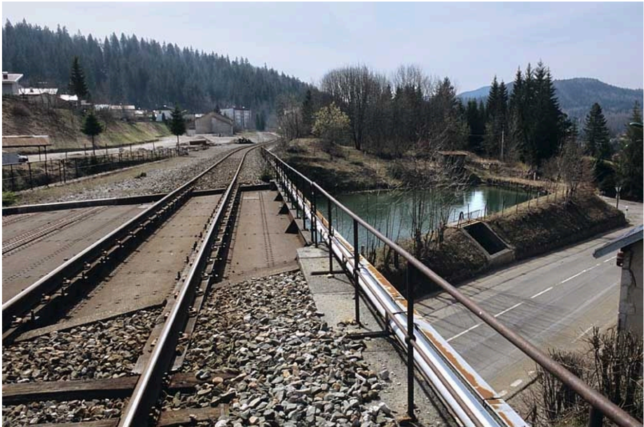
Pont et viaduc : tablier depuis la voie côté Andelot-en-Montagne, avec bassin de retenue Gaudard.
