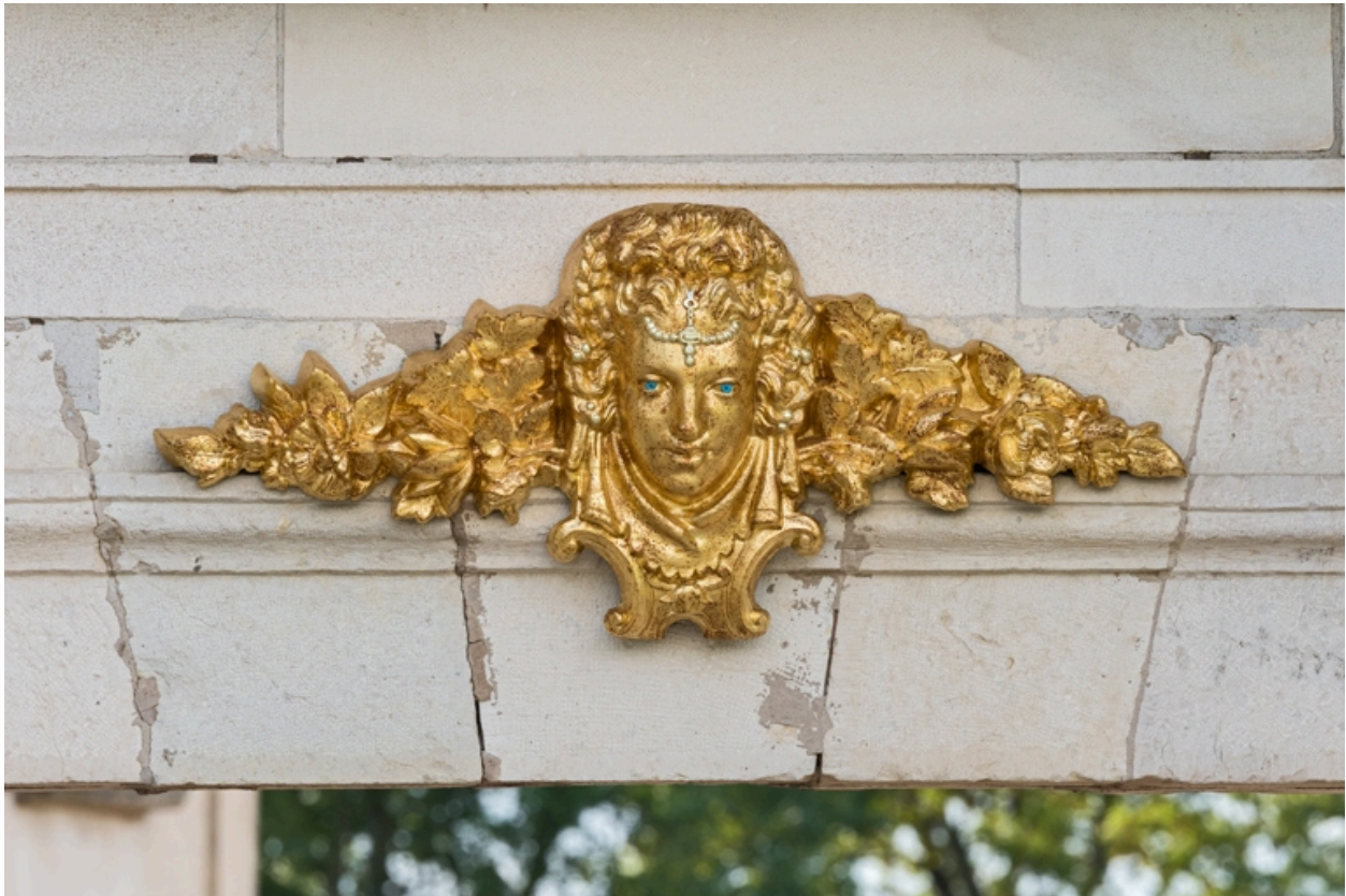
Galerie (linteau de la porte cochère) : masque en fonte peinte (il se trouvait côté cour avant 2022).
