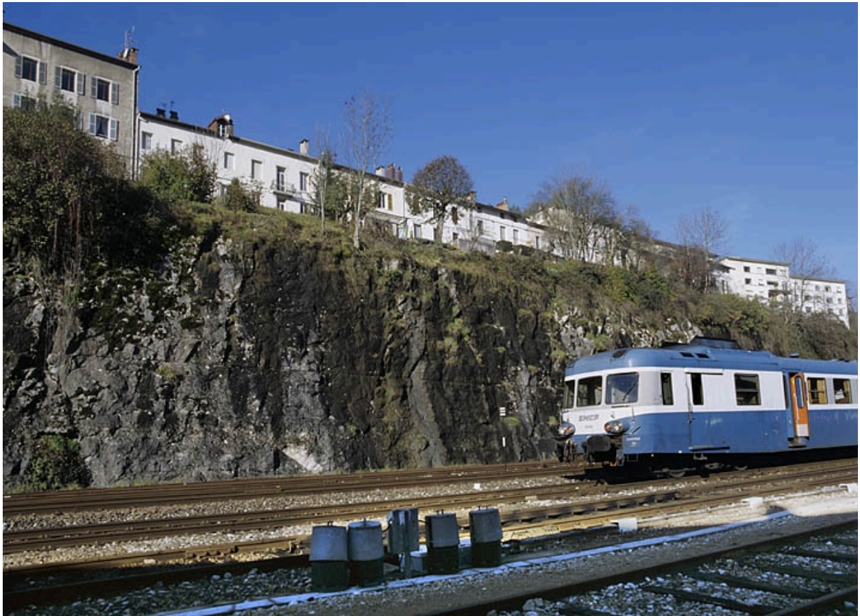
Bouteilles de gaz d'une rampe de réchauffage d'aiguilles.
