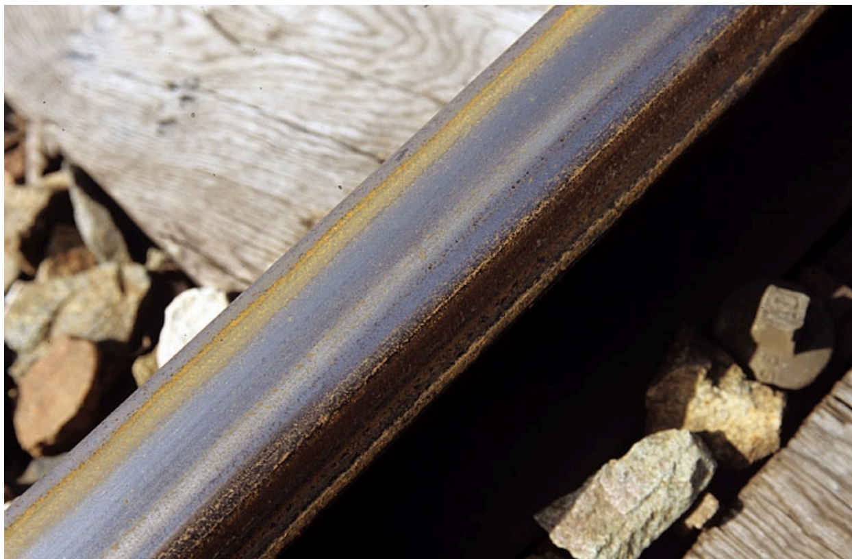
Usure d'un rail, sur le viaduc de Morbier.
