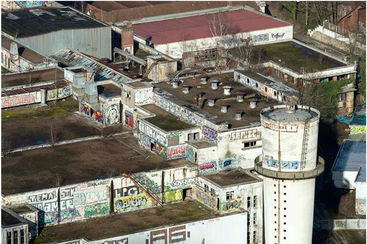
Etat en 2016. Usine A : tags sur les ateliers d'étirage et filature nylon.
