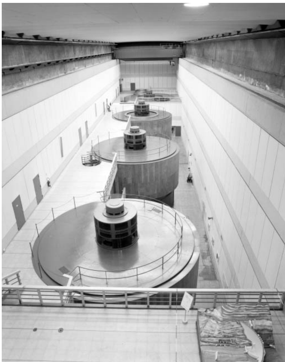
Vue d'ensemble de la salle des machines.
