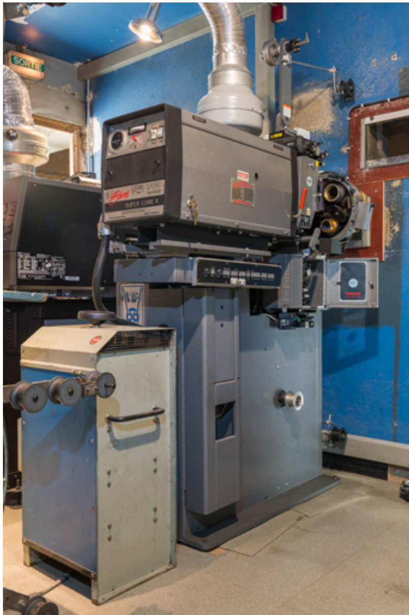
Projecteur Simplex et redresseur Prevost, de trois quarts arrière droit.
