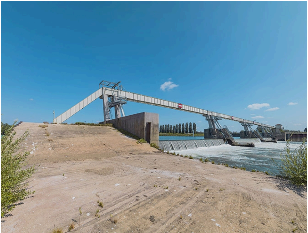
Le barrage d'Ormes vu depuis la pile ovale reliant ses deux parties.
