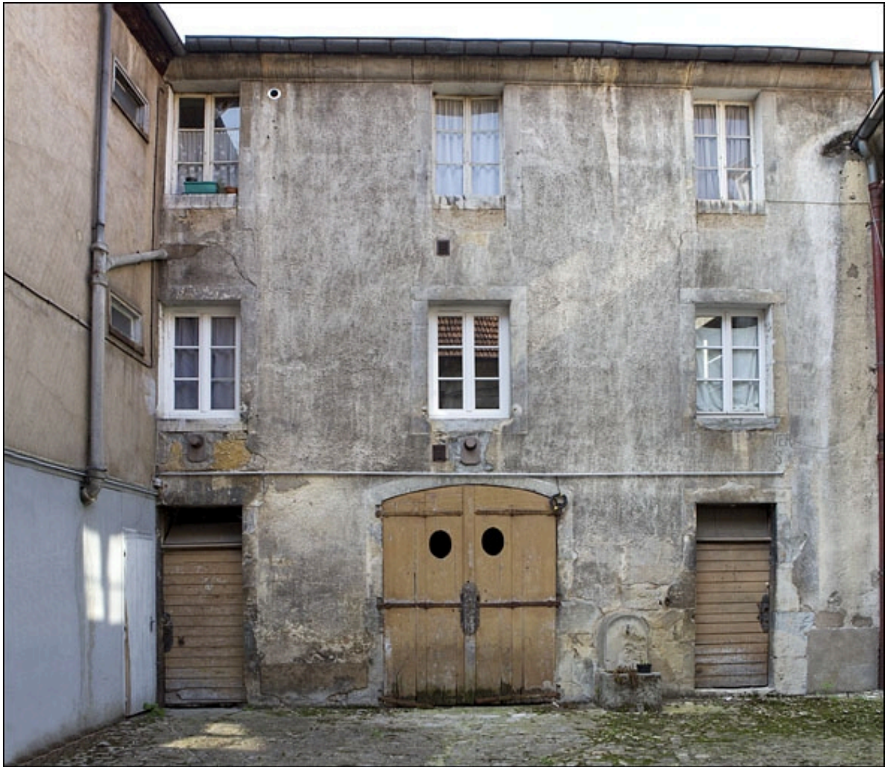
Vue de la façade antérieure du deuxième logis secondaire, au fond de la deuxième cour.
