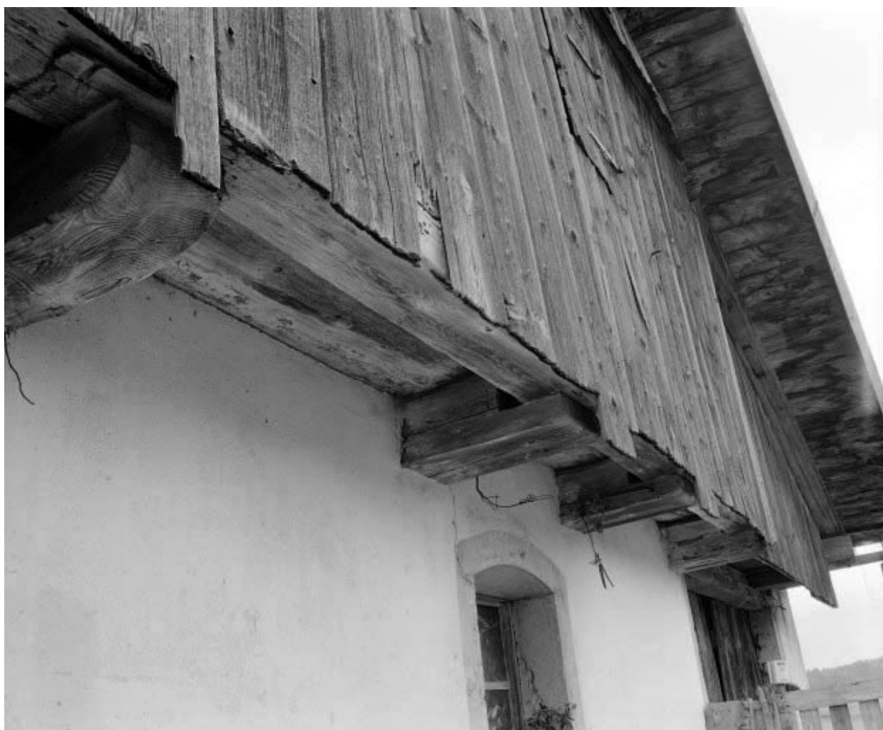
Les Combes : ferme située au lieu-dit La Motte, surplomb de la "lambrechure".
