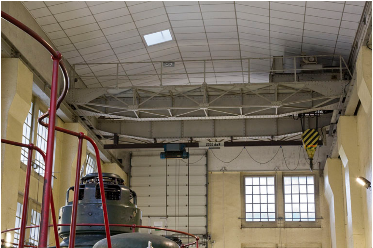
Centrale : pont roulant.
