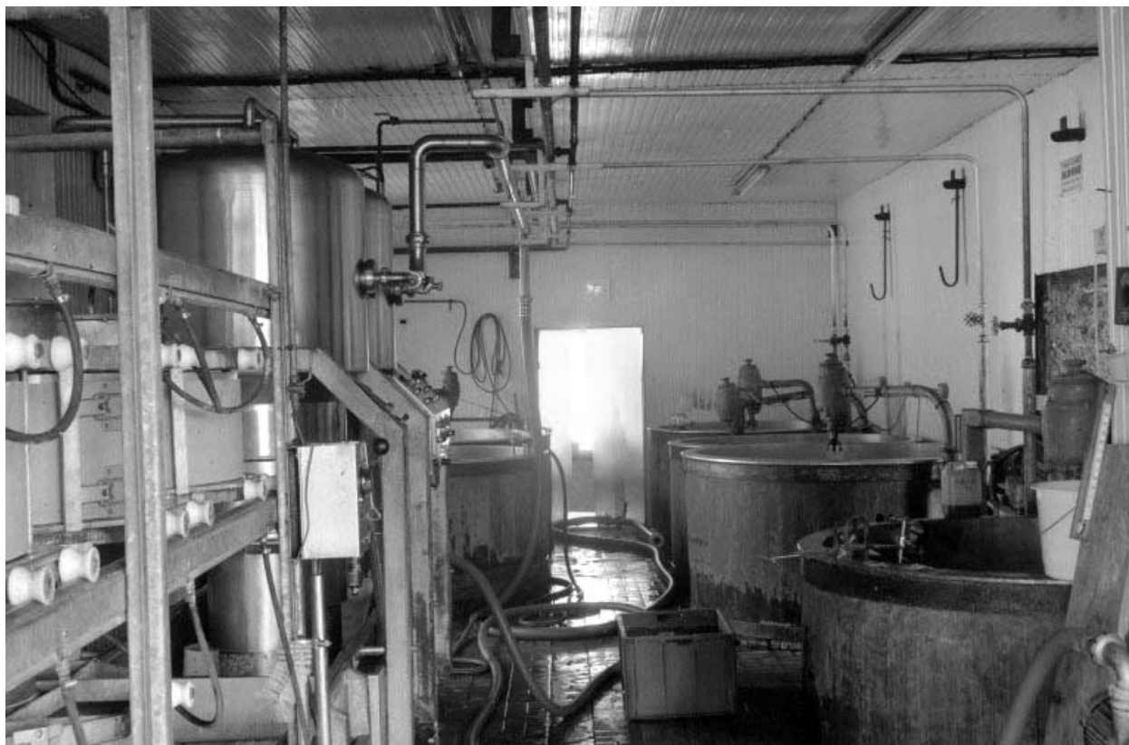
Intérieur de l'atelier de fabrication.
