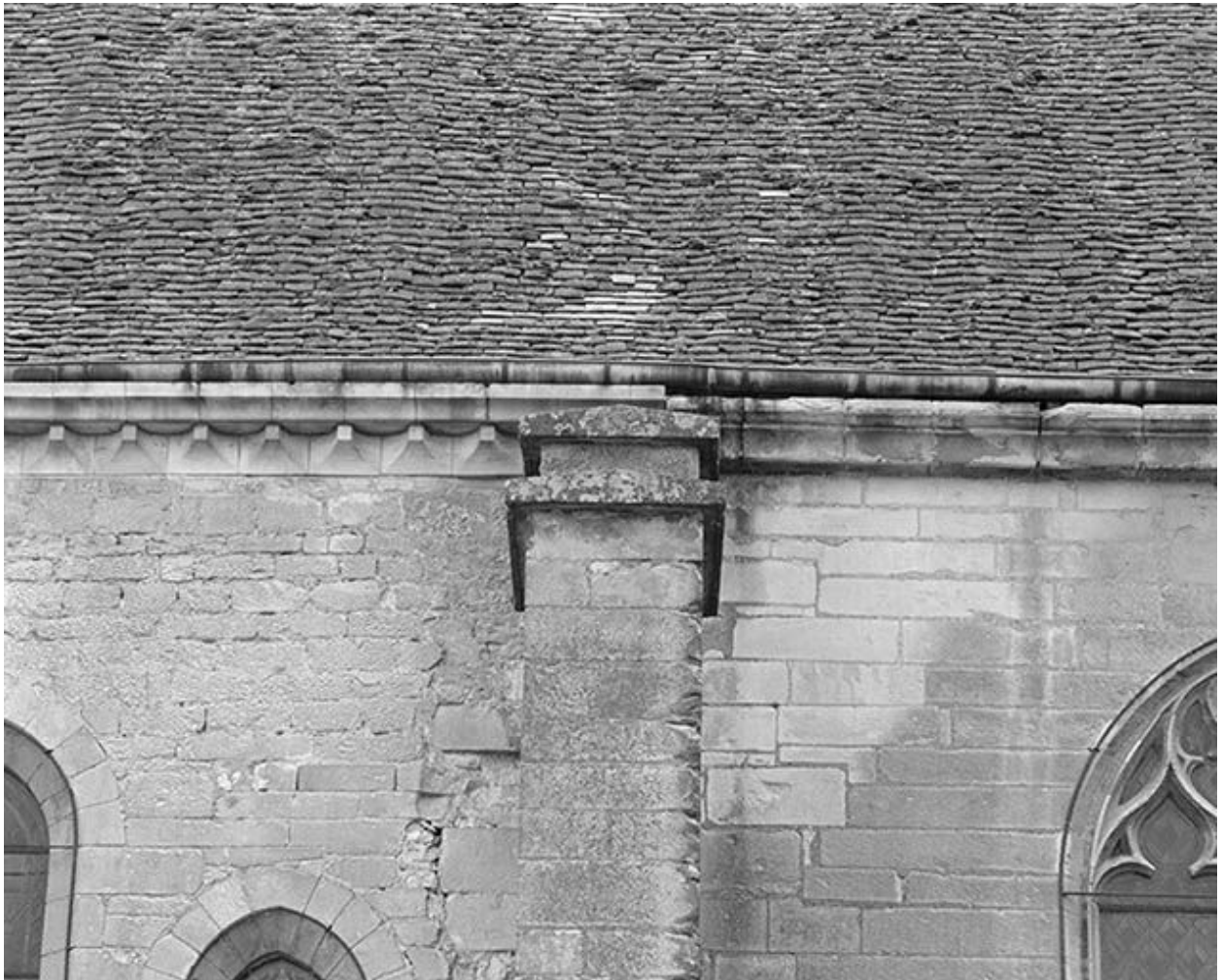
Elévation gauche : traces de collage entre les 4e et 5e travées de la nef.
