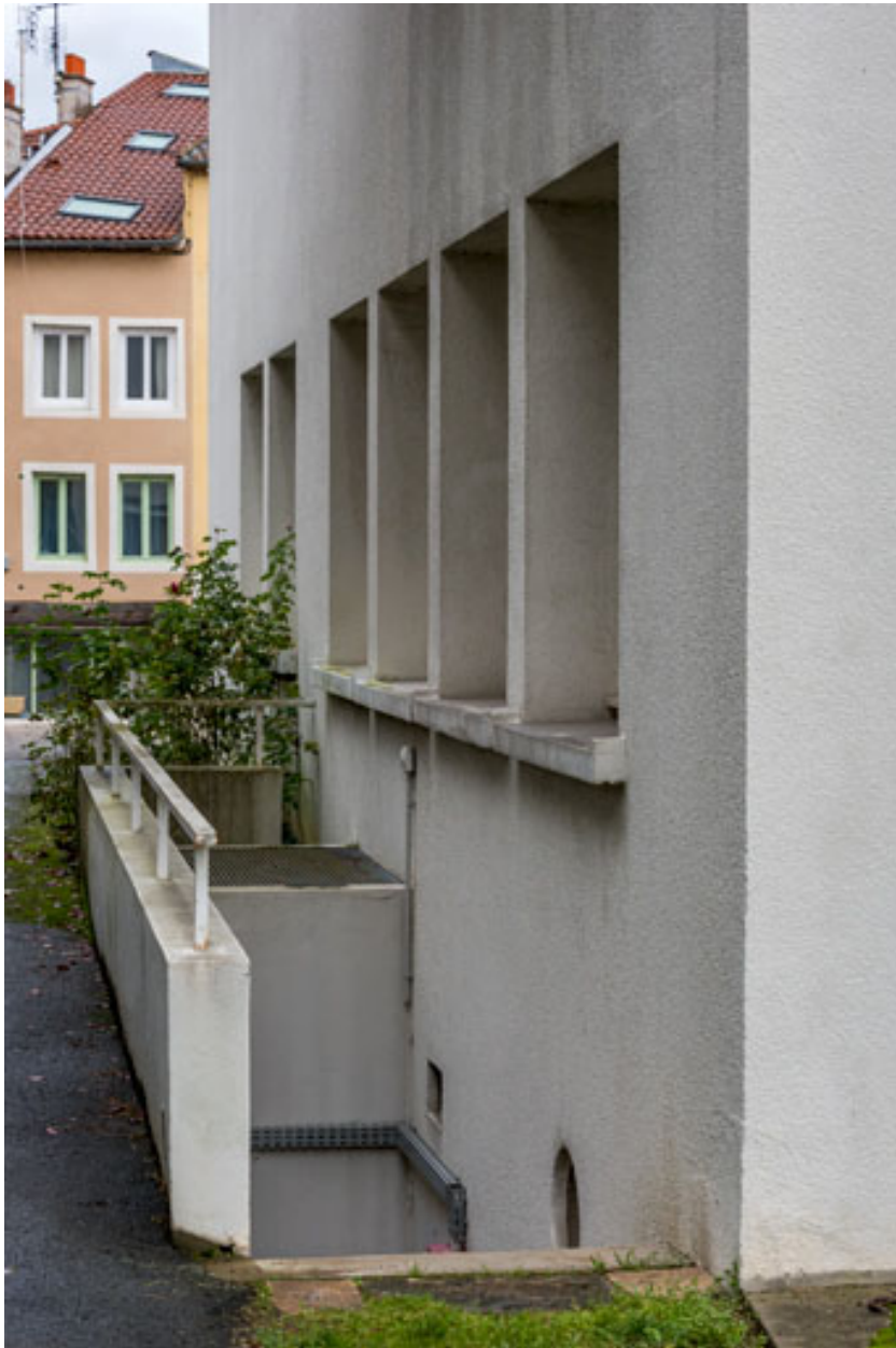
Vue partielle de la façade nord et de l'escalier desservant la chaufferie en sous-sol.
