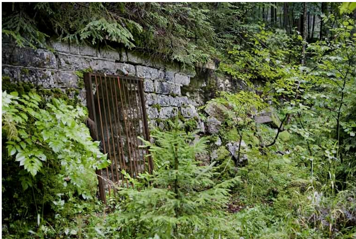
Chambres de mine : vue d'ensemble de l'entrée des galeries centrale et sud-ouest.
