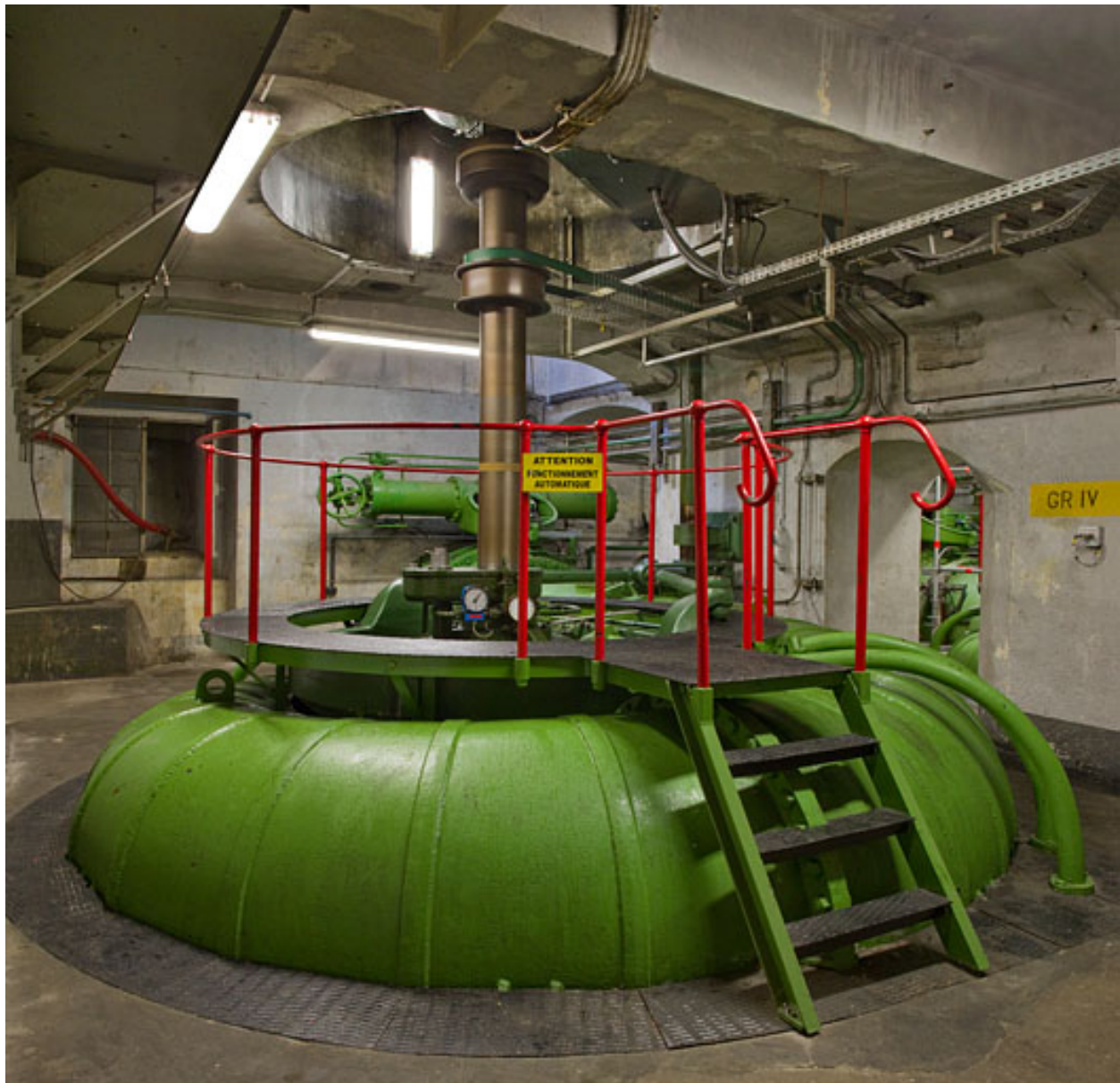
Centrale hydroélectrique de Liebvillers : bâche de turbine à l'étage de soubassement.
