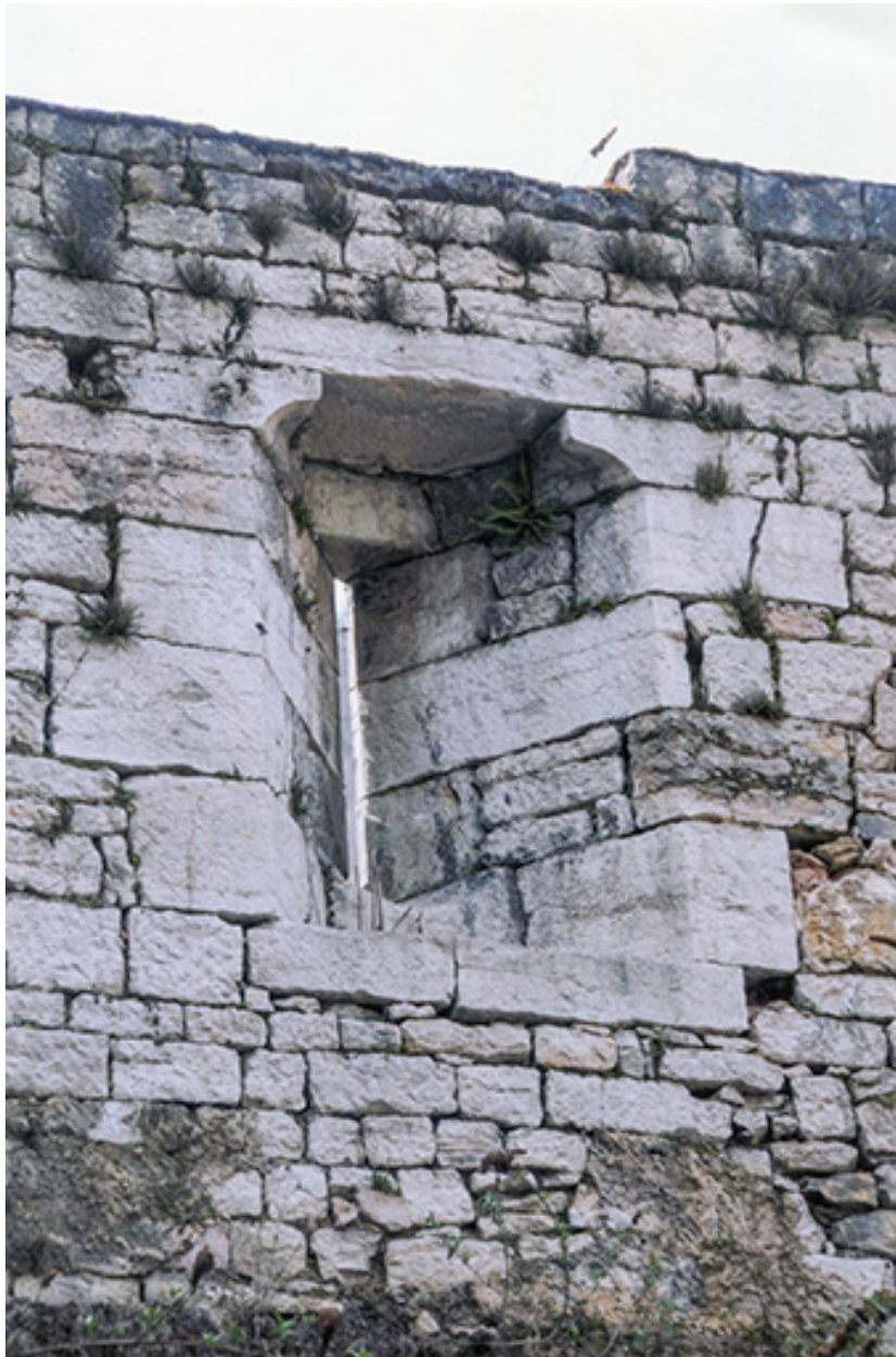
Embrasure de meurtrière dans le rempart conservé au nord du pont Saint-Nicolas, 2011.
