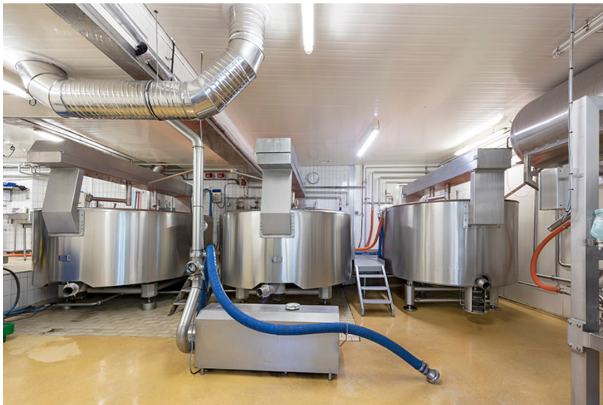
Intérieur de l'atelier de fabrication : les cuves.
