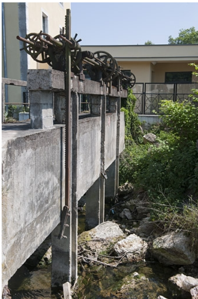
Système de vannage du bief de dérivation.
