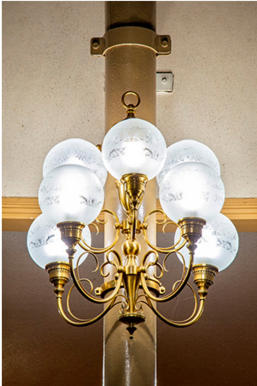
Grand Kursaal : luminaire d'applique, sur une colonne.
