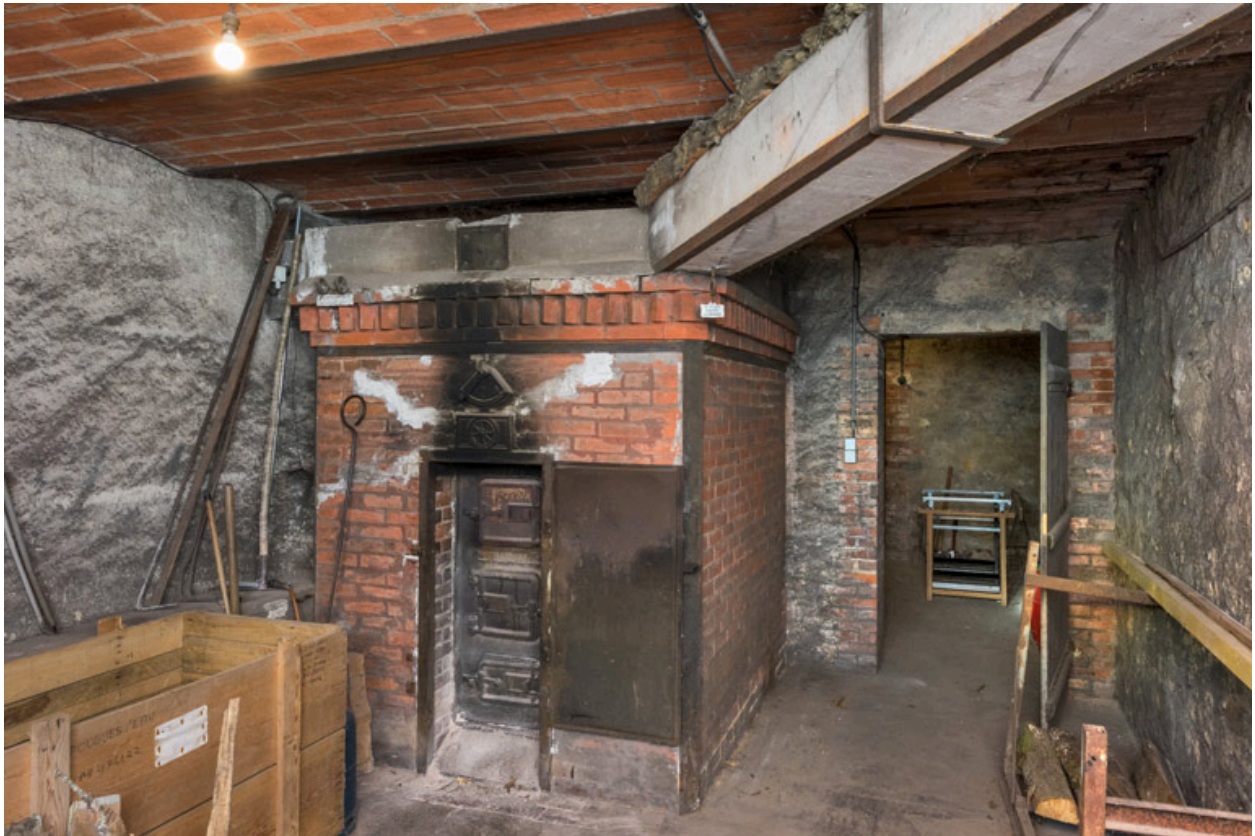
Calorifère au sous-sol.
