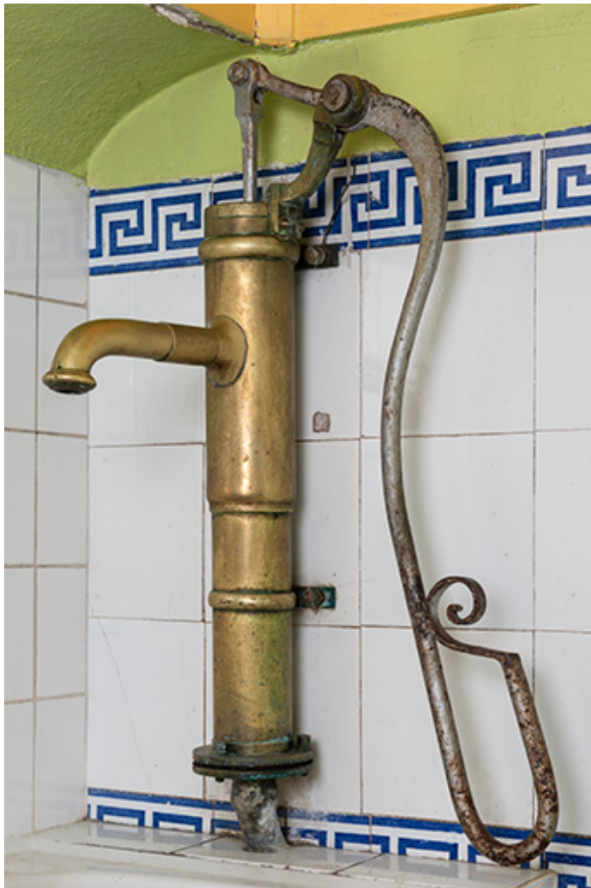
Rez-de-chaussée, cuisine, pompe à main.
