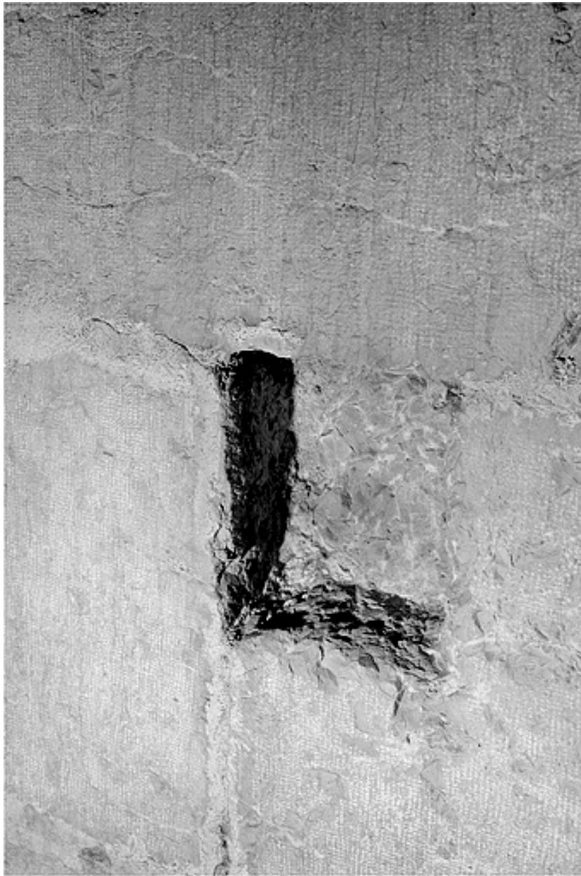
Trou de boulin dans la sixième travée nord de la coursière du vaisseau central.
