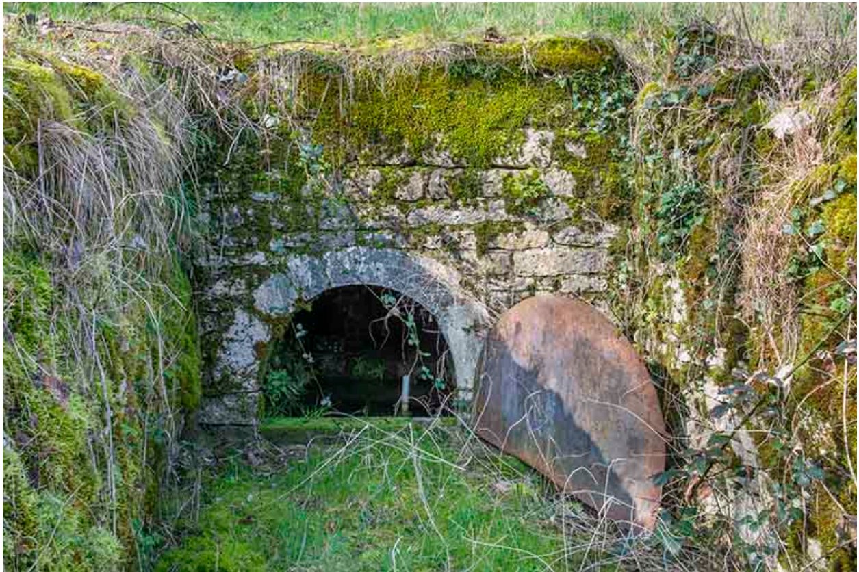
Captage de la source.
