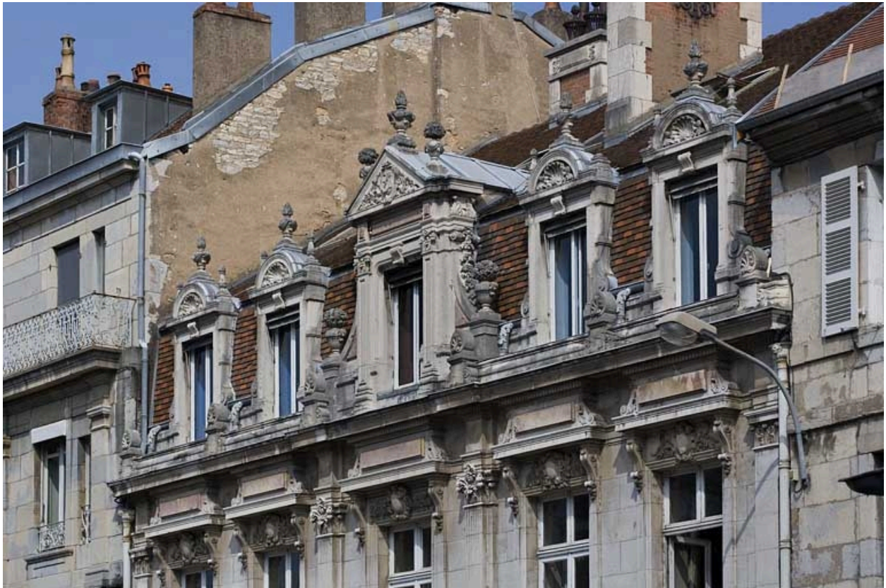
Vue d'ensemble de la partie supérieure de la façade sur rue, de trois quarts droit.
