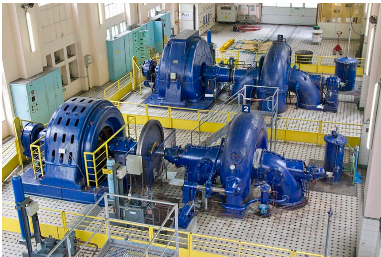
Groupe n° 2 (au premier plan) de la centrale hydroélectrique du Refrain (Charquemont), associant une turbine Escher-Wyss à un alternateur de la SACM avec excitatrice en tête d'arbre.
