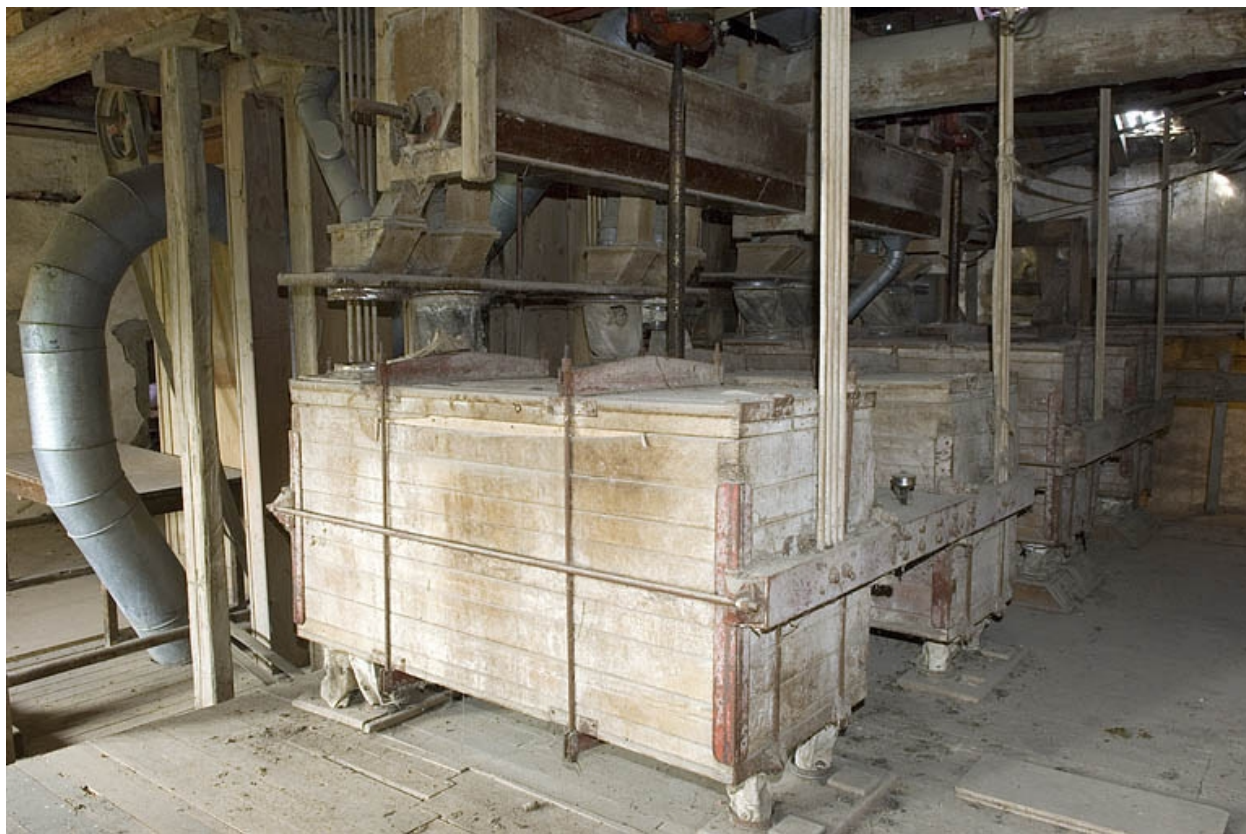
Vue d'ensemble des plansichters (3e étage).
