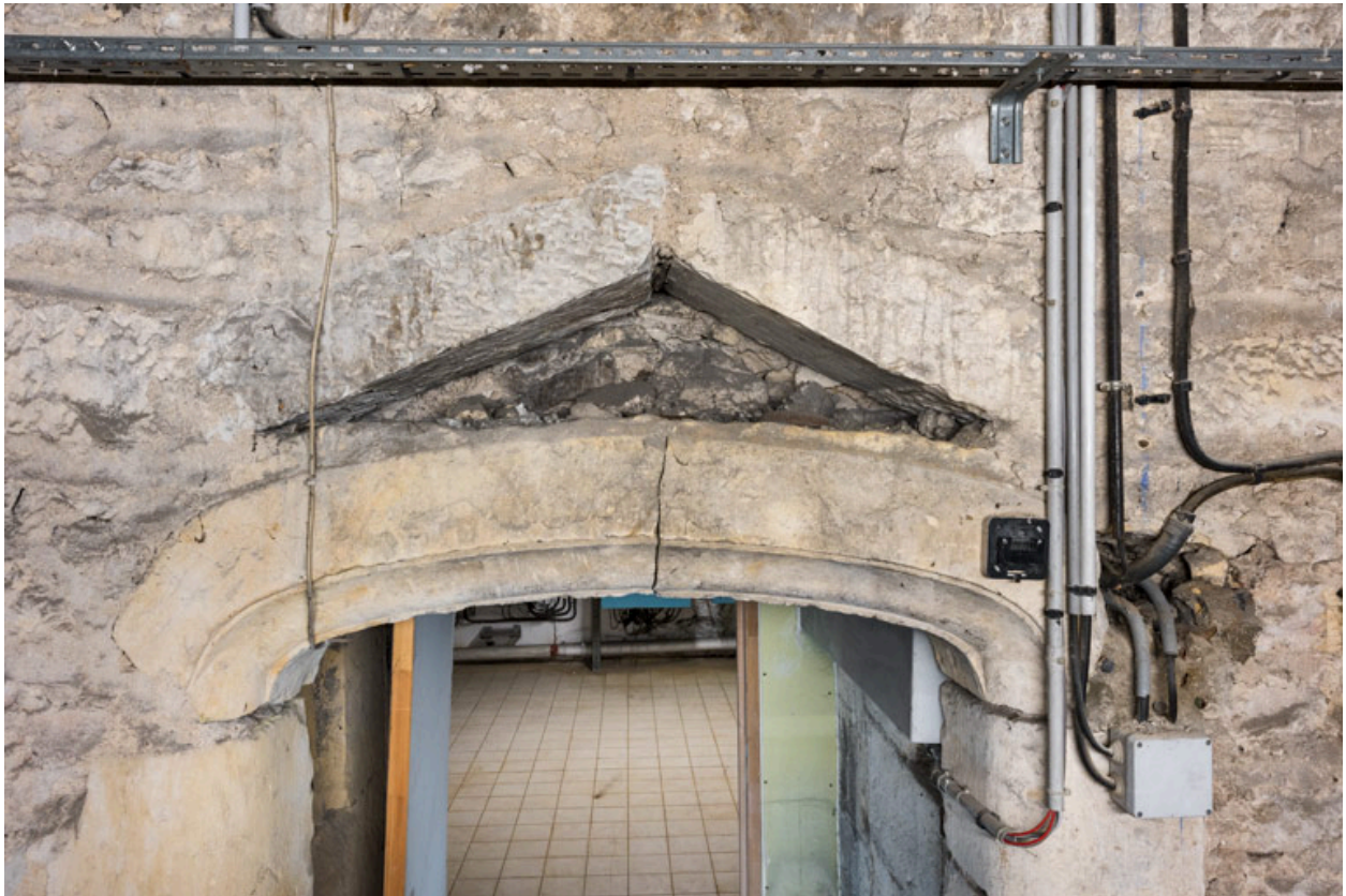
Etage de soubassement, partie droite : entrée de la chaufferie (détail du linteau).
