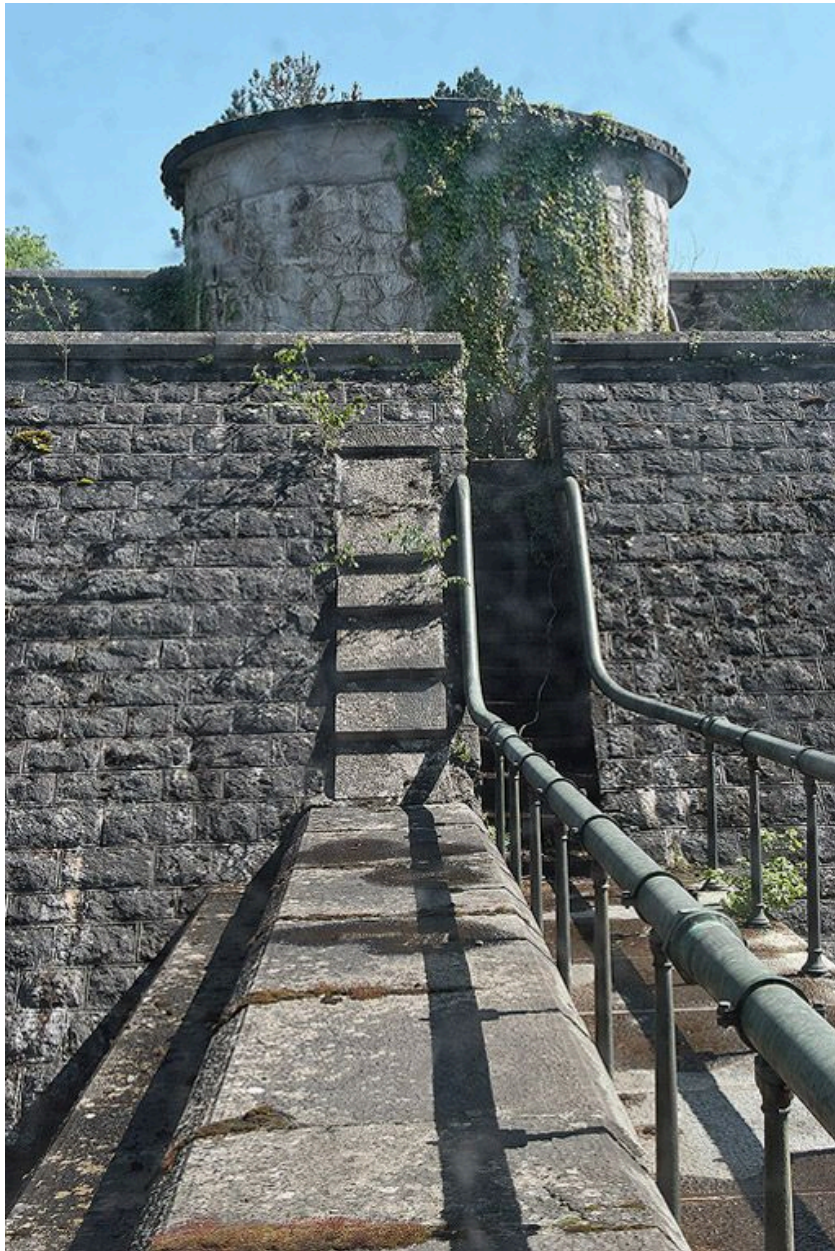
Aqueduc entre le réservoir et les bains d'Aligre, vue en direction du réservoir.
