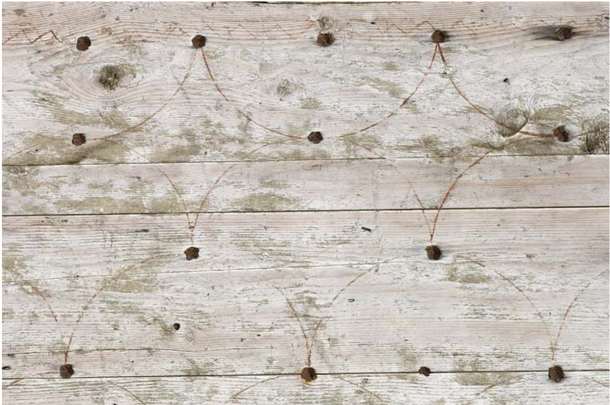
Ferme d'Entre-les-Fourgs (rue de Jougne, 2020 AD 173 ?) : détail d'une porte de grange montrant les tracés au compas utilisés pour positionner les clous de manière régulière.
