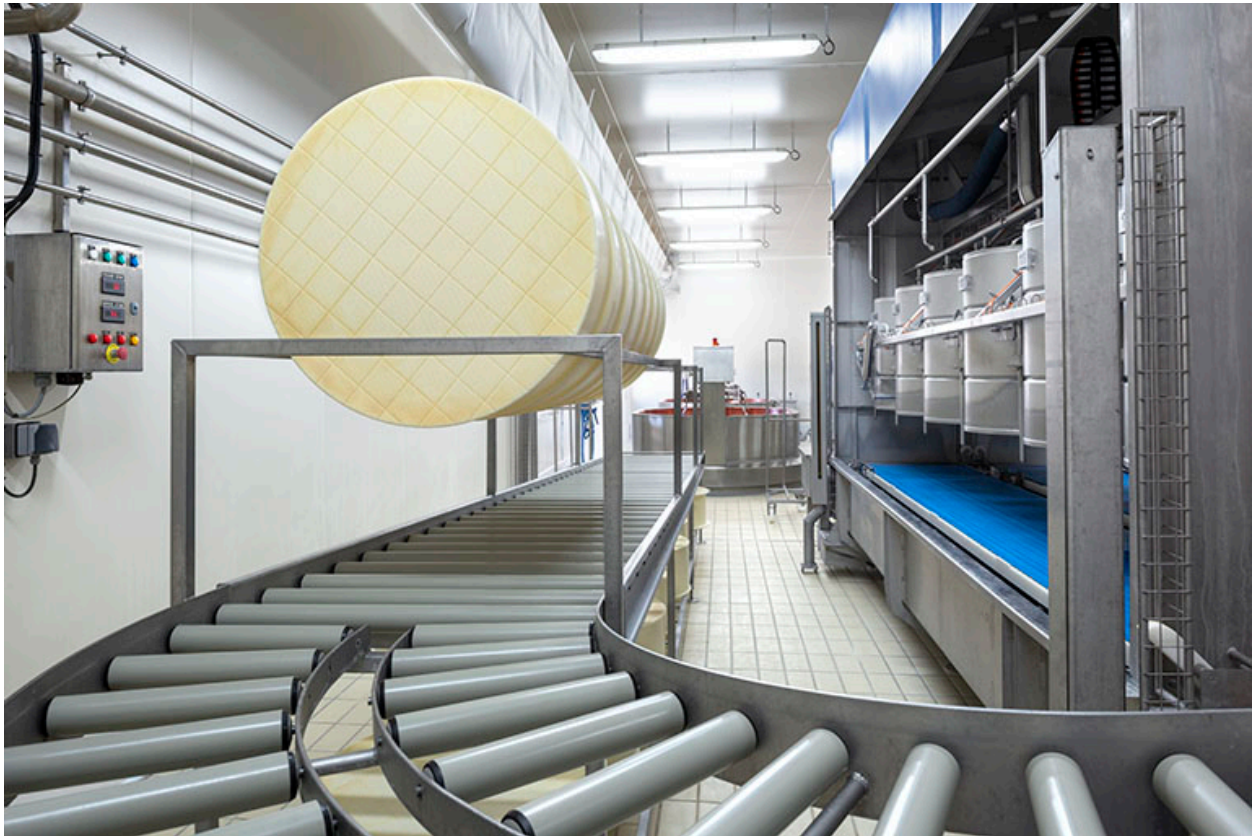
Installation de moulage et convoyeur.
