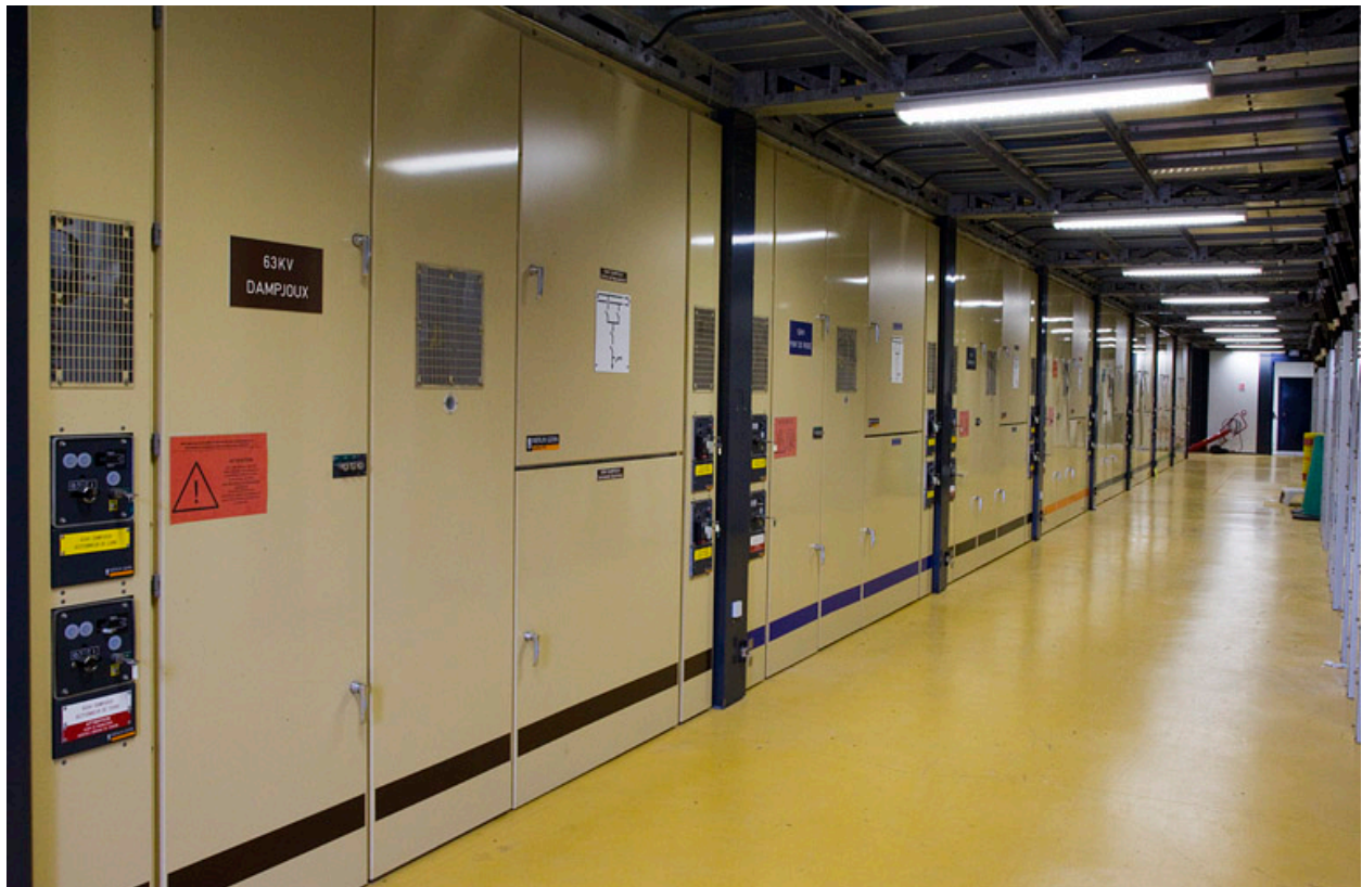
Transformateur RTE : intérieur.
