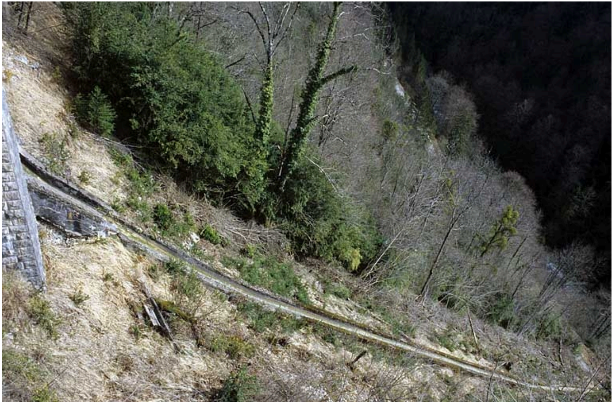
Viaduc de la Grande Roche : vue de trois quarts plongeante sur l'aqueduc.
