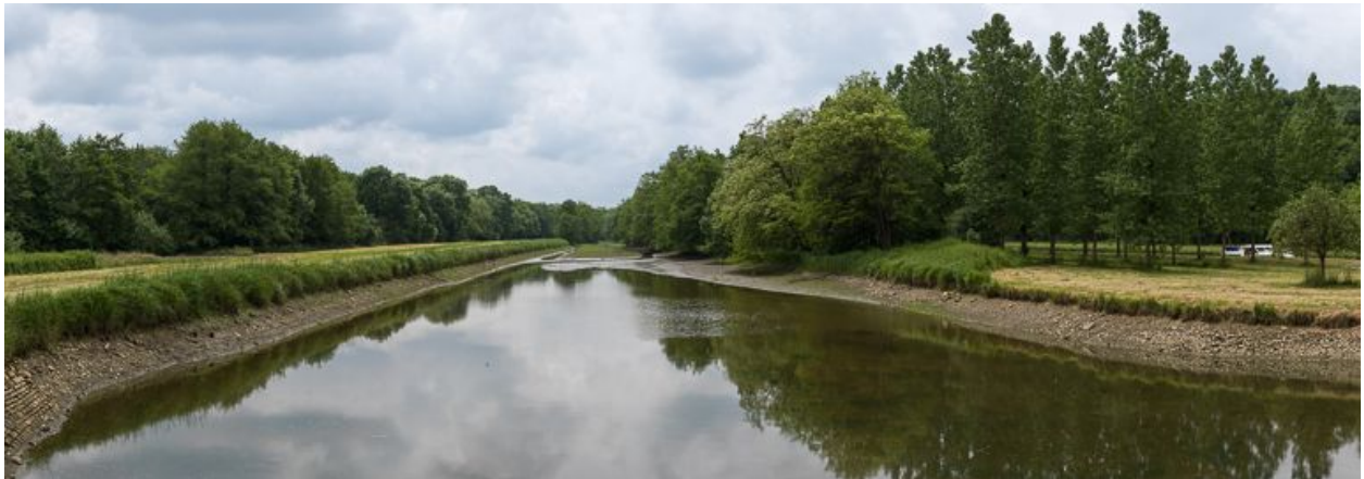
Corbigny, vue d'ensemble de la rigole d'alimentation prise depuis le déversoir de fond.
