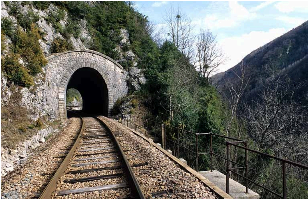
Tunnel du Champ de Bienne : tête côté La Cluse (sud). Mur de soutènement à gauche.
