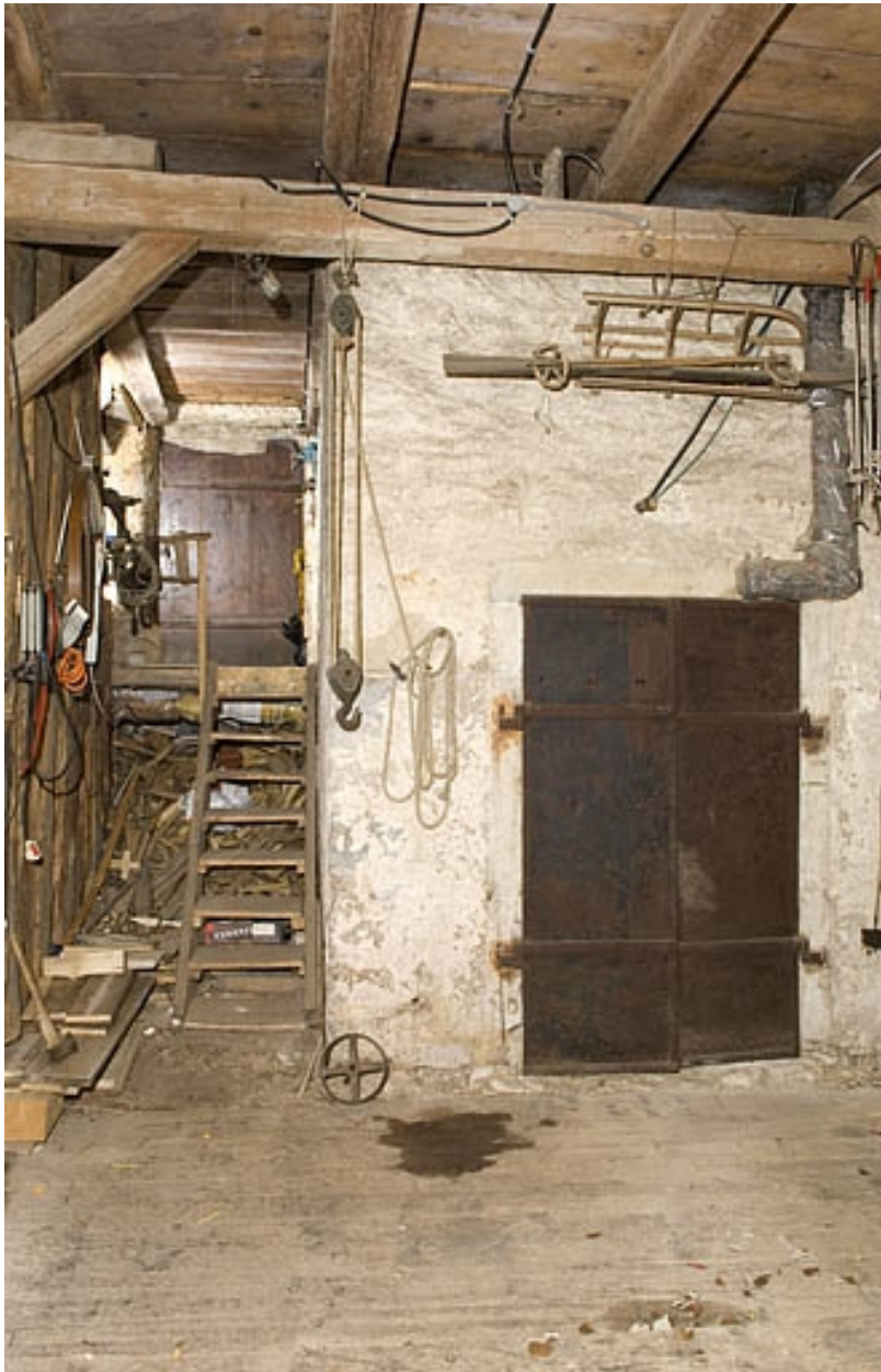
Porte coupe-feu à deux vantaux, vue du côté parties agricoles.
