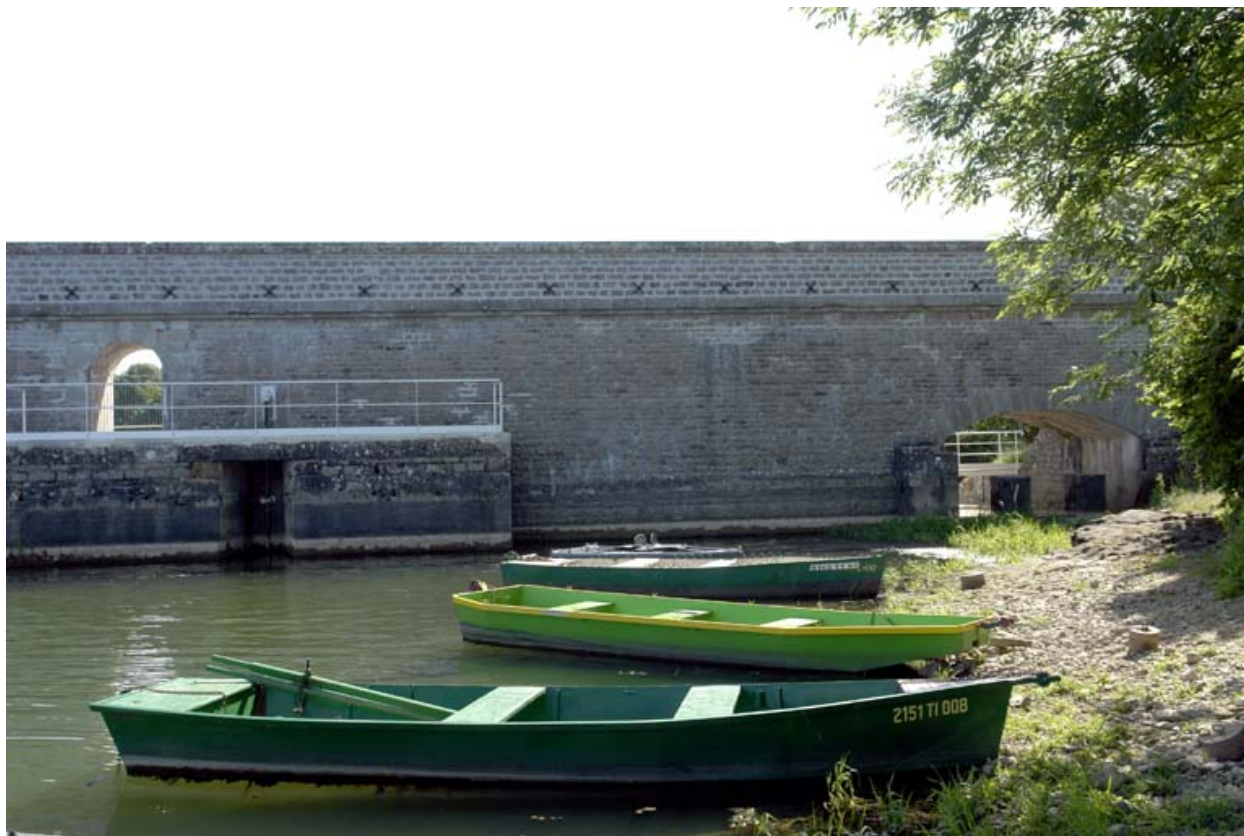
Vanne de fond et déversoir de superficie.
