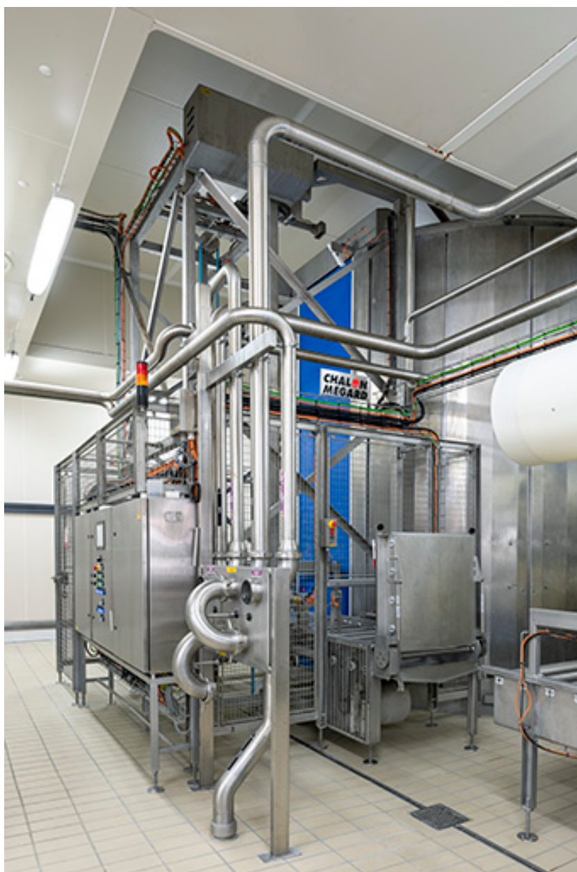
Tour de pressage : vue arrière.
