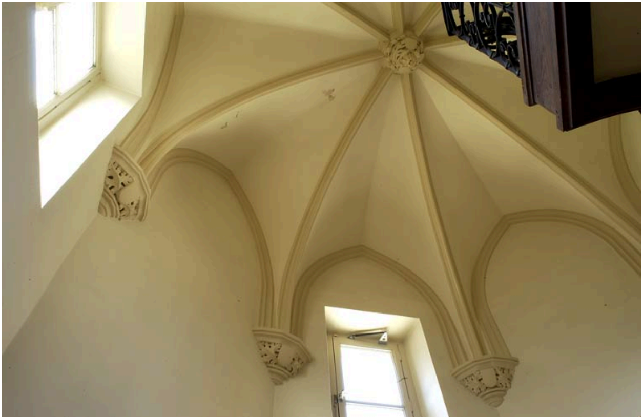
Escalier en vis néo-gothique desservant la partie sud de l'aile orientale : voûte.
